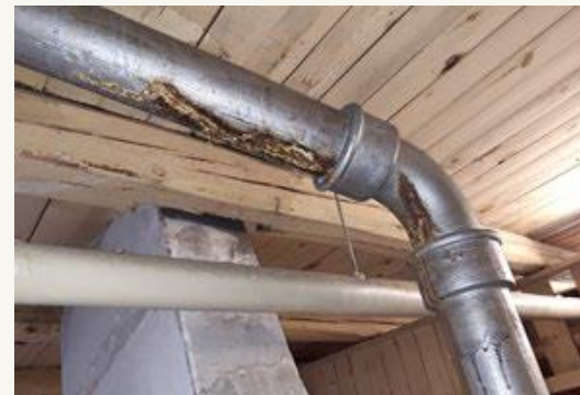
Tæret afløbsledning på loft.
