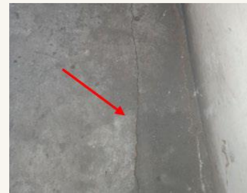
Revne i gulv - overbeton, set i tørrerum.
