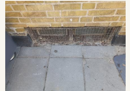
Kældervindue i terrænniveau.
