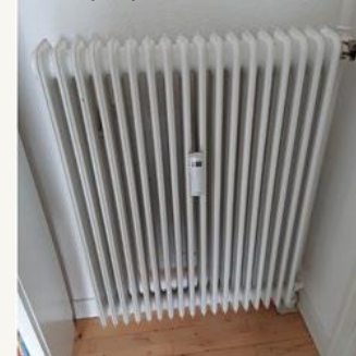
Pladejerns radiator i lejlighed
