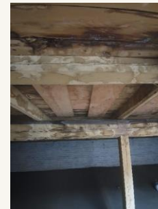
Rådskader på underside tagbrædder.
