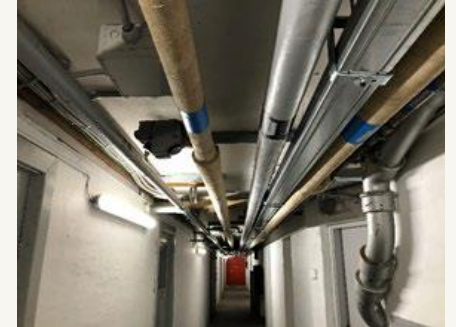
El-kabelkanal og kabelføringer m.v. i kældere
