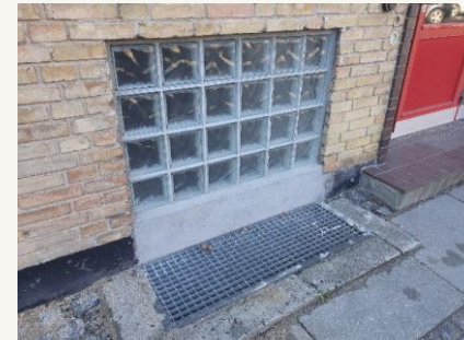
Tilmuret lyskasse, Blok 2.
