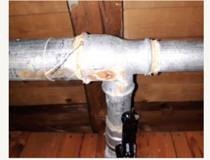
Tæring på brugsvandsrør
