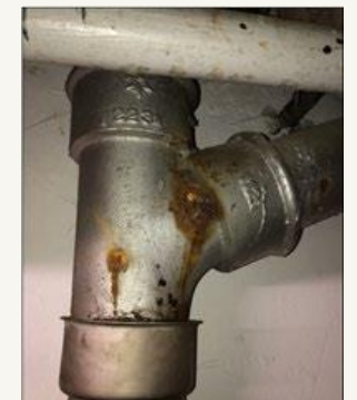
Tæring og pletvis reparation af faldstammer.
