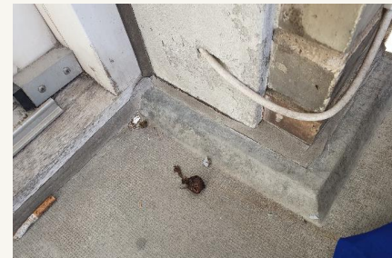
Fugeslip ved fugelukninger mellem bundplade og murværk.
