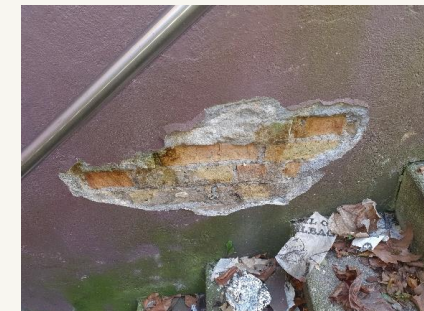
Defekt vægpuds ved kældernedgang under ejendomskontor
