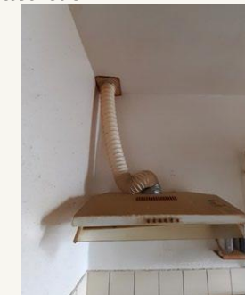
Eksempel på beboer monteret emhætte på udsugning i køkken
