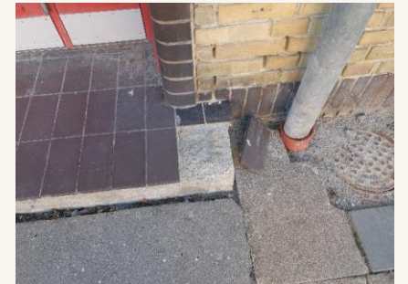
Trappesten med løse klinker
