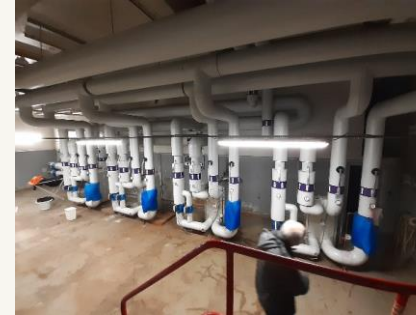
Renoverede blandesløjfer i varmecentral
