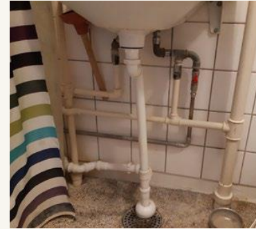
VVS installation på badeværelse. Eksempel på blandede materialer
