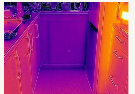
Kuldebro i indvendig eftersisolering.
