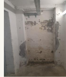
Fugtskade på kælderydervæg.
