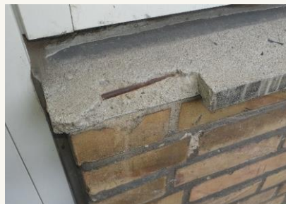
Afknækket betonsølbænk med blottet armeringsjern.
