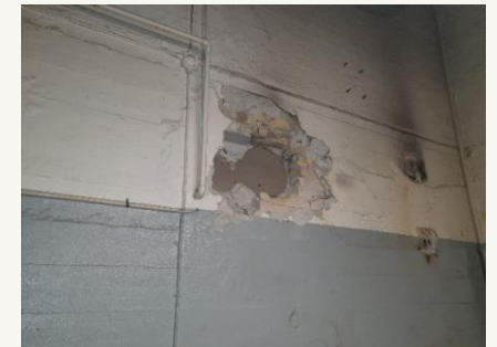
Skader på væg i mellemste niveau.
