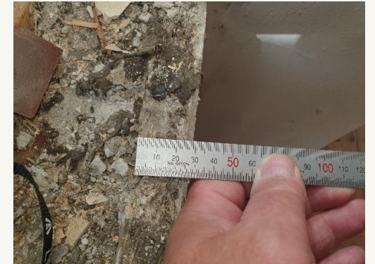
Oprindelig kuldebroisolering af træbeton.
