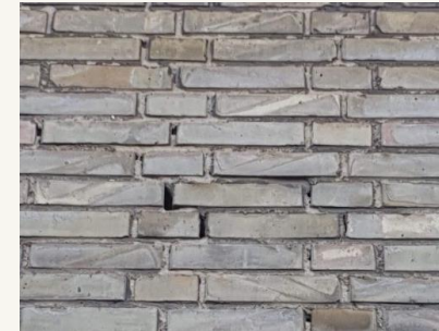
Billede af udvaskede studsfuger.
