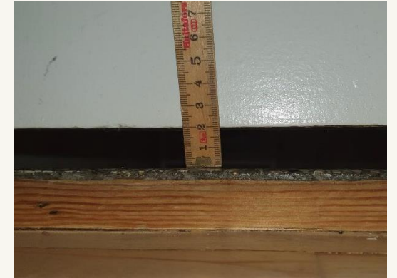
Luftspalte under vådrumsdøre.
