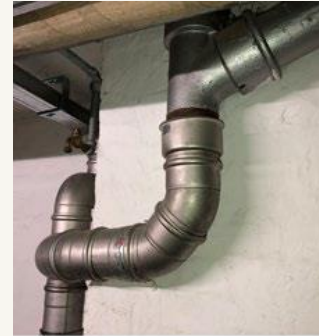
Faldstamme i kælder
