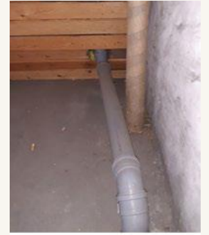
Faldstammeudluftning på loft
