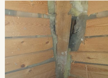
Manglende isolering under grat.
