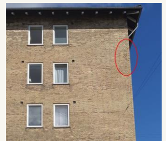
Revner i sydgavl, blok 9
