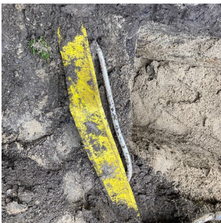
Foto 20.3 Eksisterende nyere stikledning i jord.
