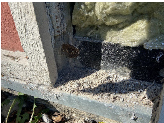
Foto 9.31. Sokkeldetalje ved facade mod betonindfatning. Betonsøjlen står på fundament og betonrem (sort) støder op til søjlen. Smøremembranen er påført front af betonrem samt synlig overside og yderside af fundament.
