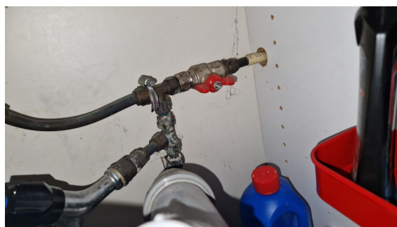
Foto 17.8. Brugsvand under køkkenvask, hvor der fordeles fra køkkenet til badeværelse. Rørene er udført i kobber.
