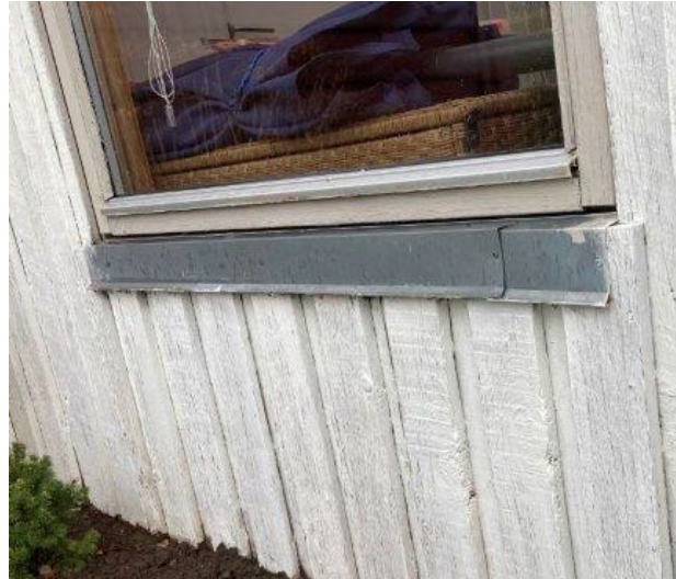
Foto 10.22. Vindue i udestue. Dårlig udført inddækning under vindue. Manglende vedligehold.
