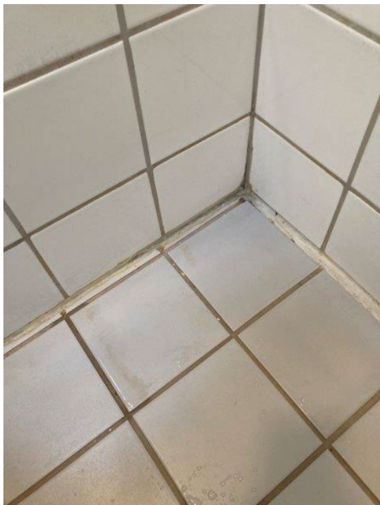
Foto 13.7. Elastisk fuge med skimmeldannelse
