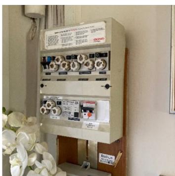
Foto 19.1.9 Eksempel på ældre boligtavle udvendigt.
