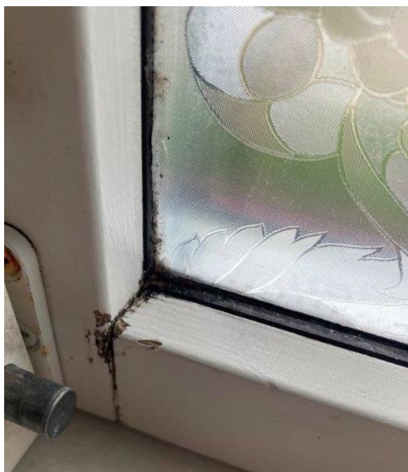
Foto 10.12. Fugtplamager i hjørnet af rammen (i soveværelse). Skimmelpilamager, afskallet maling og opfugtet træværk.
