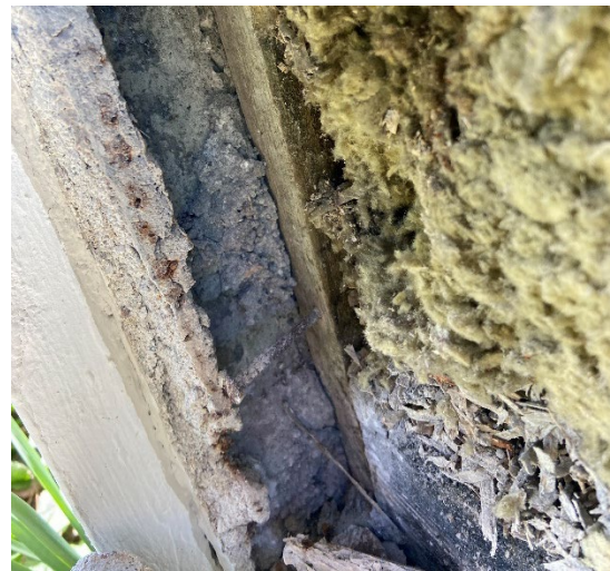
Foto 9.36. Sokkeldetalje ved facade mod betonindsatning. Der er flere steder registreret en trælægge monteret til betonsøjlen. Prøvestedet var tørt og der var ikke tegn på en opstigende fugtpåvirkning af vægkonstruktionen.
