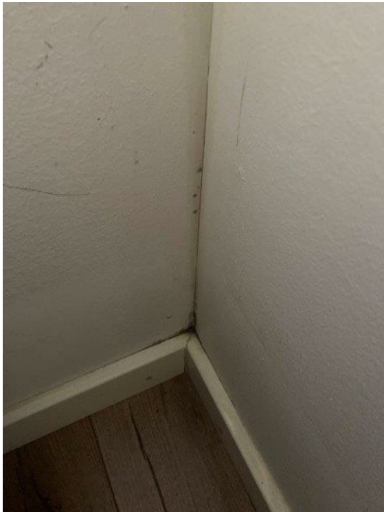
Foto 22.1. Skimmeldannelse i depot som er inddraget ulovligt til værelse.
