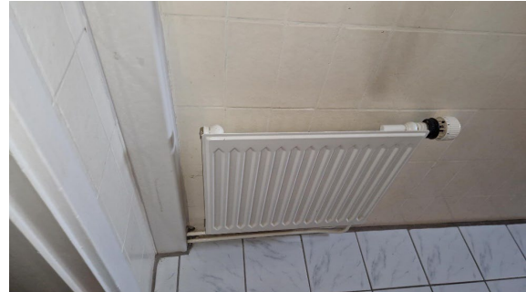
Foto 15.2. Radiator i badeværelse. Panelet med fordelingsrør er ført lodret på væggen til venstre for radiatoren.
