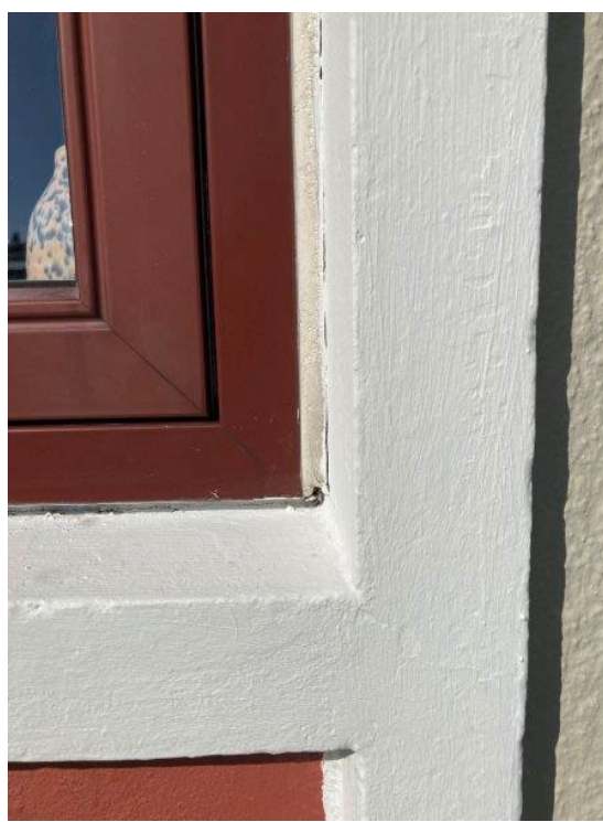
Foto 9.8. Betonramning i god stand, dog med revner i vinduesfuge
