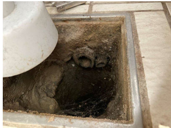
Foto 13.6. Ældre udskiftet afløb uden vandlås med synlig betonudstøbning, ikke udført korrekt. Betondækket opfugtes med fare for vandskade. Beboer klagede over problemer med afløbet.
