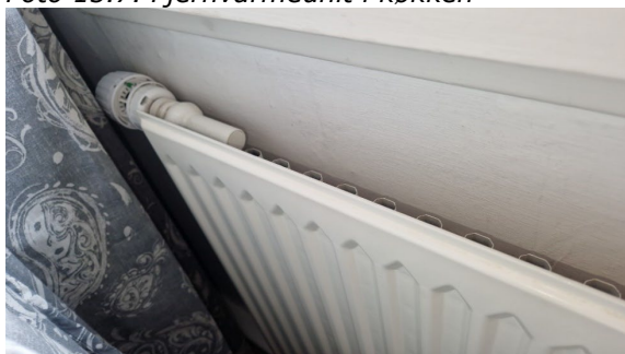
Foto 15.9. Radiator med termostat i soveværelse
