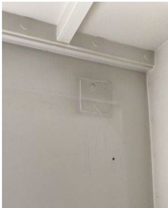
Foto 9.22. Samme aftræksventil set indefra er lukket med plade og overmalet. Tapet i området omkring sortner.
