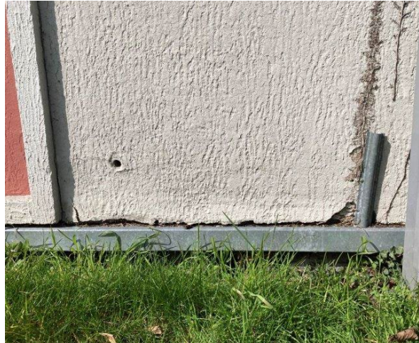
Foto 9.26. Udvendig kabelføring ved soklen. Pudslaget er nedbrudt i bunden og der er et hul sandsynligvis fra fastgørelse af et stillads.
