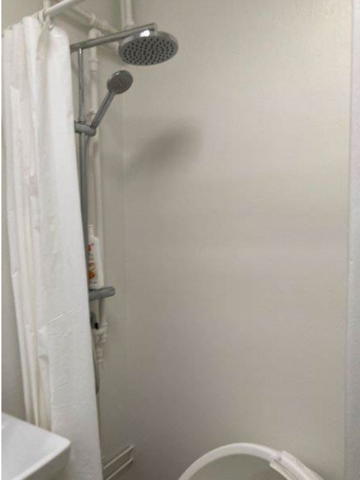
Foto 13.3. Pudset og malet væg i bruseniche. Synlige rør med gennemføringer i vådzone.
