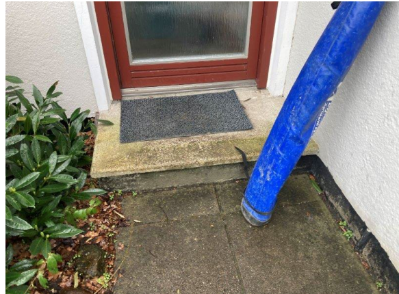
Foto 22.4. Trappetrin foran hoveddør, manglende tilgængelighed.
