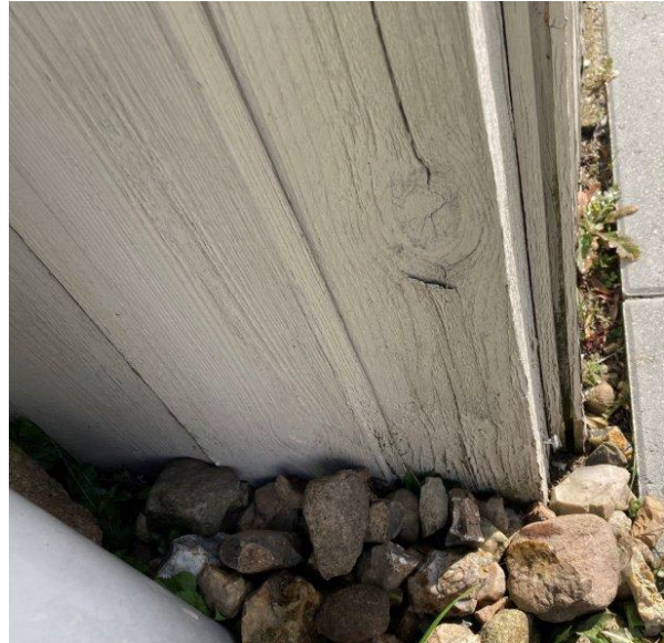
Foto 9.30. Opfugtet træbeklædning på skur med manglende malervedligehold. Træværk i kontakt med jord (opfugtes).
