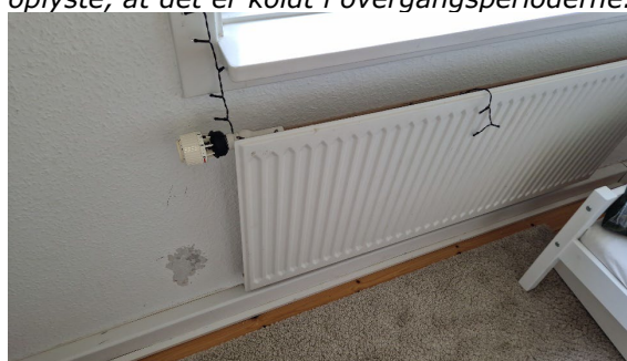
Foto 15.14. Radiator med termostat i et soveværelse.
