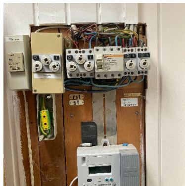
Foto 19.1.6 Eksempel på ældre boligtavle indvendigt.
