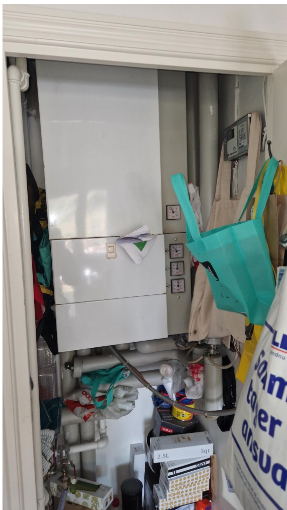
Foto 15.7. Fjernvarmeunit i køkken
