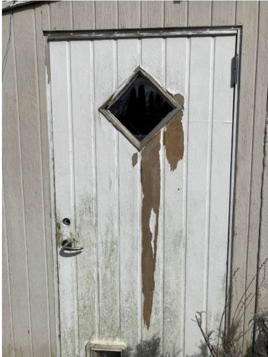
Foto 11.9. Dør til udbygning af skur. Manglende vedligehold med algebegroning, afskallet maling og synligt opfugtet træværk. Døren er malet hvid, i uoverensstemmelse med lokalplanens retningslinjer. Vinduets geometri er i uoverensstemmelse med bebyggelsens arkitektur samt retningslinjer i lokalplanen.
