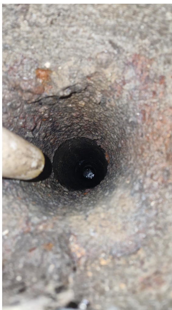
Foto 16.12. Gulvafløb under håndvask uden vandlås
