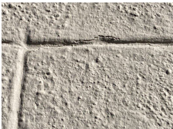
Foto 9.15. Revnedannelser i samlingerne mellem træbetonpladerne.
