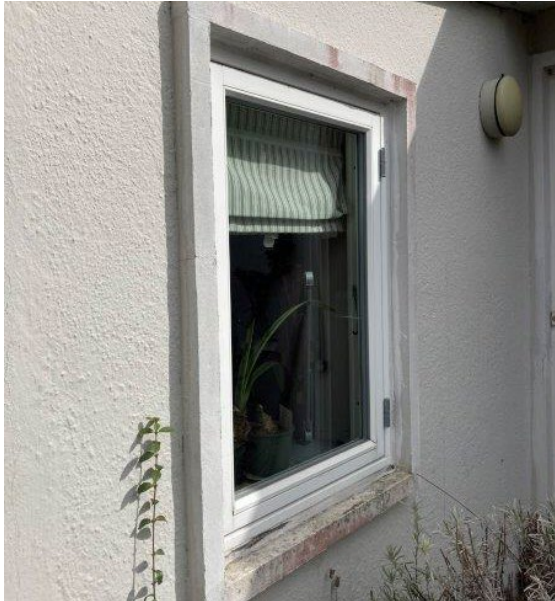
Foto 10.13. Farve på nyere udskiftet trævinduet på ved depot fraviger fra lokalplanens anvisninger. Der er skade / flig på rammen. Vinduesfugen er meget bred og fremstår med huller.
