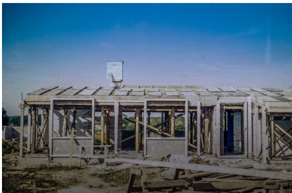
Foto 9.1. Foto fra opførelsestidspunktet. Betonsøjler i facade og gavle ses tydeligt. Over betonsøjler er udstøbt en betonbjælke sammenstøbt med betontagplade. De hvide betonindfatninger er monteret/hæftet på betonsøjlerne.
