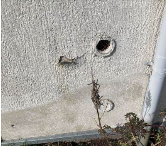
Foto 9.25. Afskallet maling med bagvedliggende algedannelser på mur. Pudsreparation på nederste del af facaden med anden type overflade. Udluftningskanal i facade og hul efter stillads.
