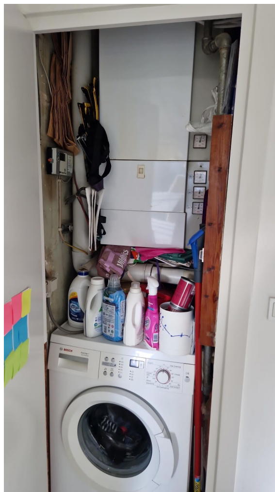
Foto 15.8 Fjernvarmeunit i køkken
