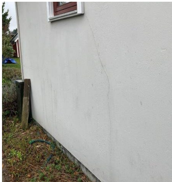
Foto 9.14. Lodret revnedannelse i pudslaget
