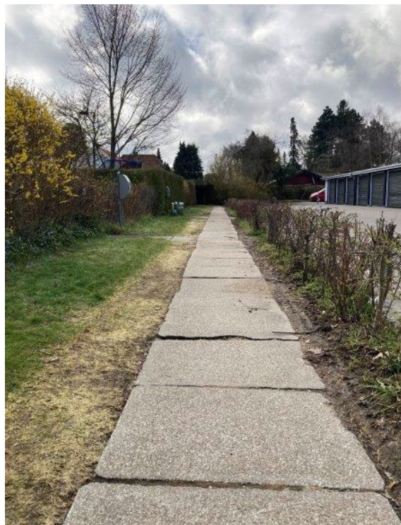
Foto 20.6. Ujævn flisebelægning, risiko for personskade.
