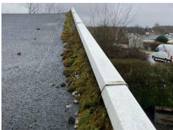
Foto 7.8. Inddækning og mosbegroning
