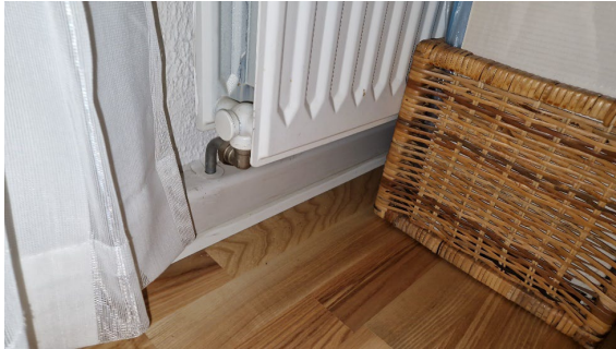
Foto 15.1. Gulvpanel med varmerør, hvor radiatorstikket er udført i kobber
