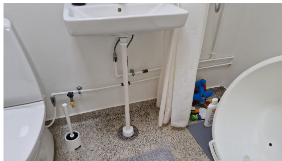
Foto 16.10. Badeværelse uden gulvafløb i brusenichen.
