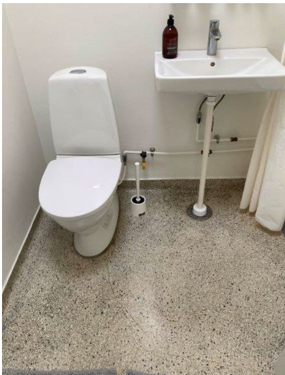
Foto 13.1. Originalt badeværelse med revnet terrazzogulv og originalt afløb.
