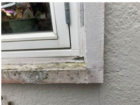
Foto 9.11. Manglende vedligehold af betonomramning. Misfarvninger, algedannelse, fugtplamager og afskallet maling. Reparation af revne under vindue er revnet på ny.
