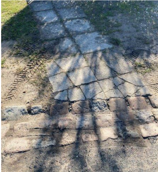
Foto 20.9. Ødelagte fliser foran indgang til havegang i dårlig stand. Manglende tilgængelighed.
