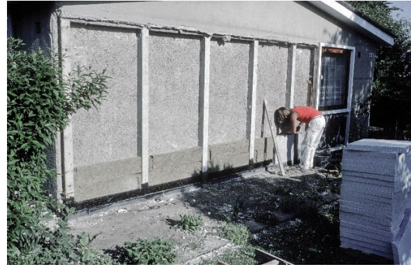
Foto 9.4. Tidligere foto af ukendt dato. Renovering af gavlmuren med isolering af hulrum og letbeton som erstatning for træbeton.
