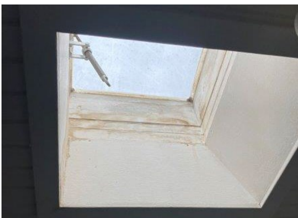
Foto 7.24. Ovenlysvindue i et depotrum med fugtskjolder
