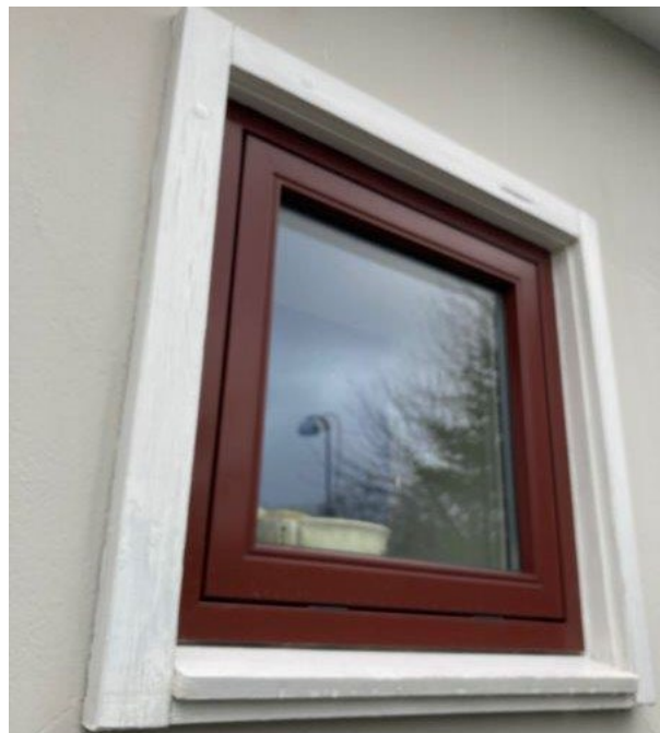
Foto 10.2. Omramning og vindue med sålbænk. Fuge mangler.
