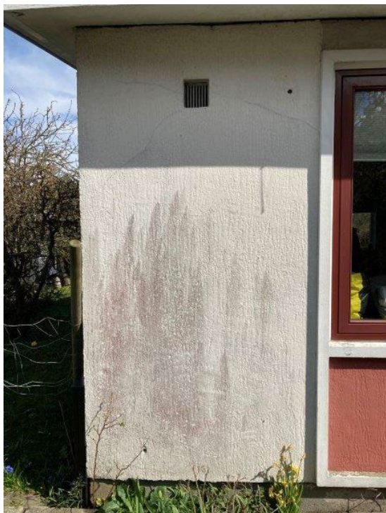
Foto 9.21. Fugtpåvirket facade og aftræksventil med rist (kanal er lukket indvendig).
