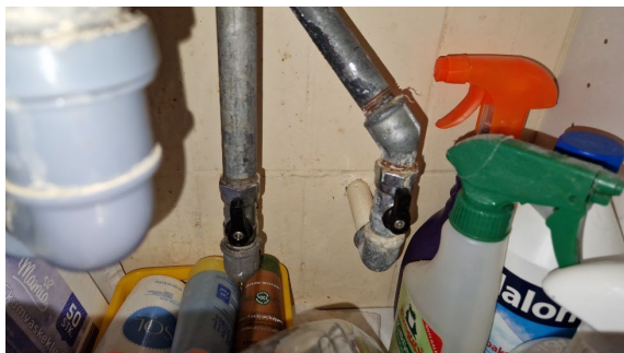
Foto 17.1. Vandinstallationer under håndvask. Rørene er udført i galvaniseret stål.
