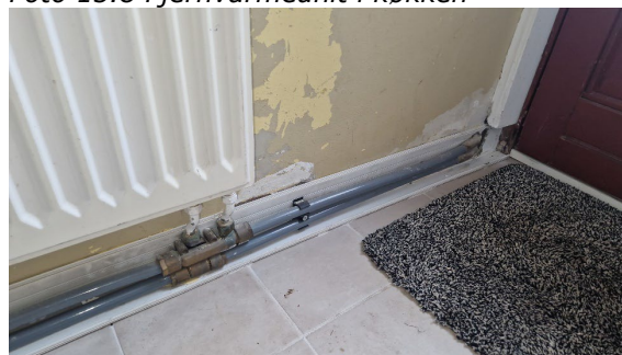
Foto 15.10. Radiator i entre, hvor tilslutningen er synlig.
