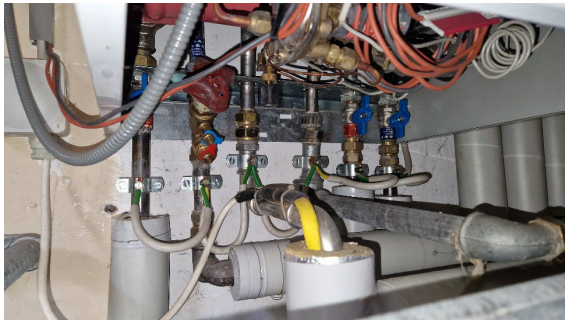
Foto 15.3. Tilslutninger til en fjernvarmeunit i en bolig.
