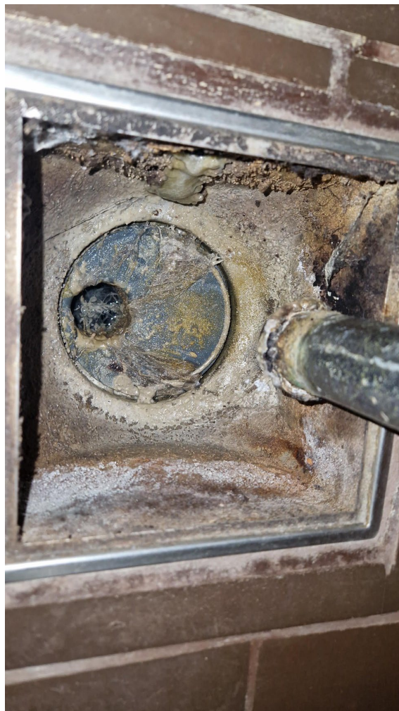
Foto 16.2. Gulvafløb under håndvask med muret opkant
