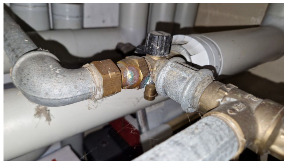
Foto 17.2. Sikkerhedsaggregat ved varmtvandsbeholderen
