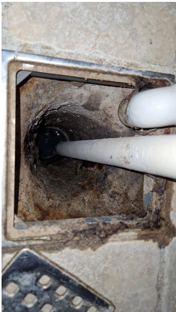
Foto 16.1. Gulvafløb under håndvask med muret opkant
