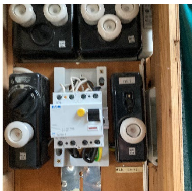
Foto 19.1.7 Eksempel på ældre boligtavle indvendigt.
