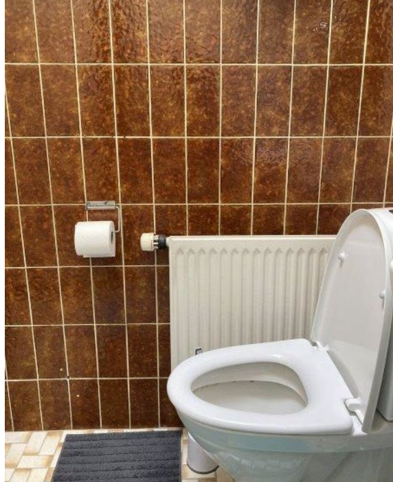
Foto 13.4. Ombygget badeværelse, ca. 70'erne. Det antages at der ikke er etableret vådrumsmembran ved ombygningen.
