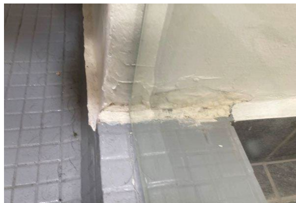
Foto 13.14. Overmalede mosaikstifter og partiel reparation ved samling med elastisk fugemasse.
