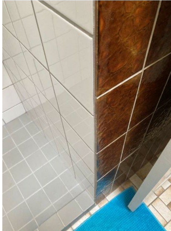
Foto 13.12. Badeværelse med fire forskellige flisetyper vidner om flere partielle ombygninger. 70'er-80'er klinker på hovedparten af badeværelset, nyere fliser på gulv og væg i bruseniche. Det er sandsynligvis anvendt vårrumsmembran ved nyeste ombygning, men ikke den ældre.
