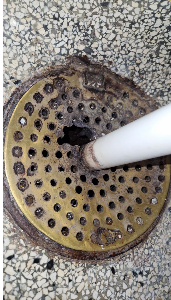
Foto 16.6. Gulv afløb under håndvask med muret opkant. Gulv afløbet er placeret i oprindelig gulvbelægning.
