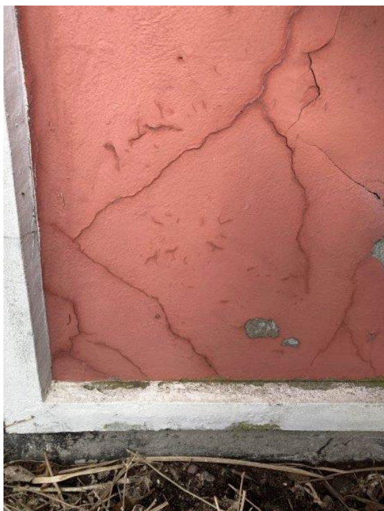
Foto 9.9. Brystning med revner og pudsafskallinger
