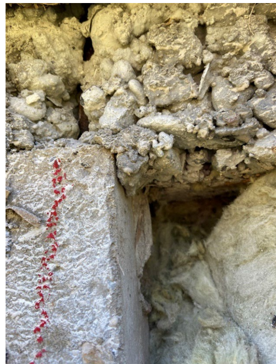
Foto 9.44. Gavl. Samling betonsøjle og betonbjælke under gavltrekant. Stenreder og revne i betonbjælke over vederlag. Bæreevnen er reduceret og samlingen har ikke den tiltænkte kapacitet.
