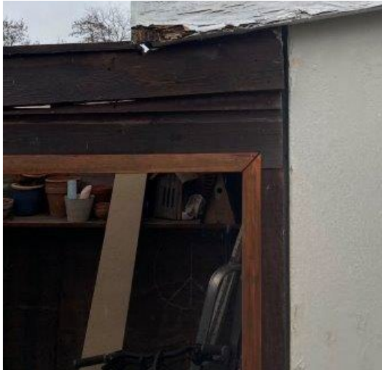
Foto 10.21. Vindue i udestue. Farvesætning på vinduet (samt træværk) på tilbygning fraviger fra lokalplanens anvisninger. Vinduet er i middel dårlig stand.
