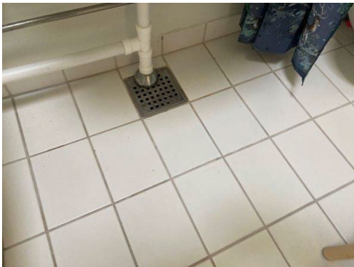
Foto 13.5. Nyere flisegulv og afløb. Ukendt om hvorvidt der er anvendt vådrumsmembran ved ombygningen.
