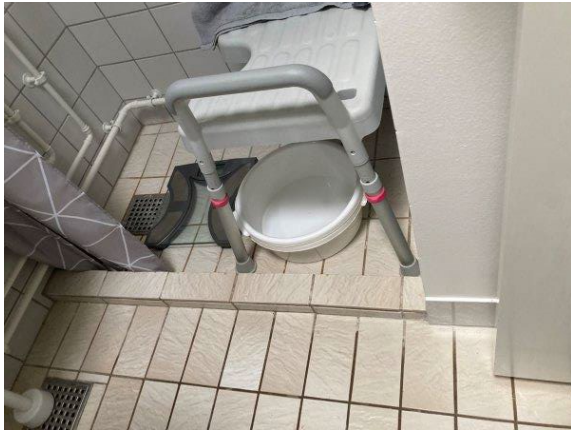
Foto 22.3. Badeværelse med opkant ved bruseniche, manglende tilgængelighed.
