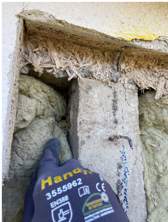
Foto 9.39. Facade. Samling betonsøjle og betonbjælke. Revne og betonafskalling af hjørne. Reduceret kontaktareal i vederlag.
