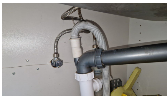
Foto 17.4. Brugsvand under køkkenvask. Skjulte rør er udført i galvaniseret stål bag/under køkkenskabene.
