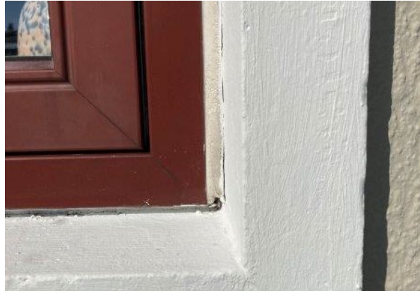
Foto 10.4. Omramning og vindue uden sålbænk. Hul og revner i fuge.
