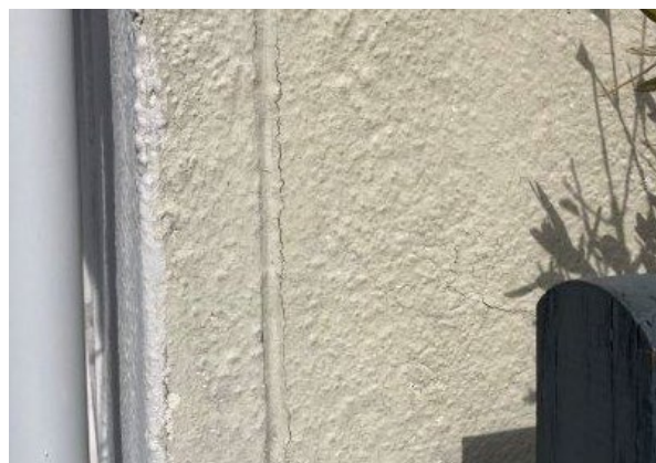
Foto 9.16. Revnedannelser i samlingerne mellem træbetonpladerne.
