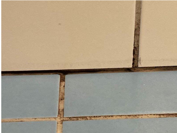
Foto 13.15. Fliser i bruseniche. Mørtelfuge mellem gulv og væg er nedbrudt. Tidsperioden for ombygningen vurderes førend krav om vådrumssikring blev skærpet.
