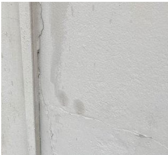
Foto 9.17. Revnedannelser i pudslag.
