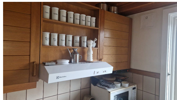
Foto 18.2. Emhætte med afkast til det fri
