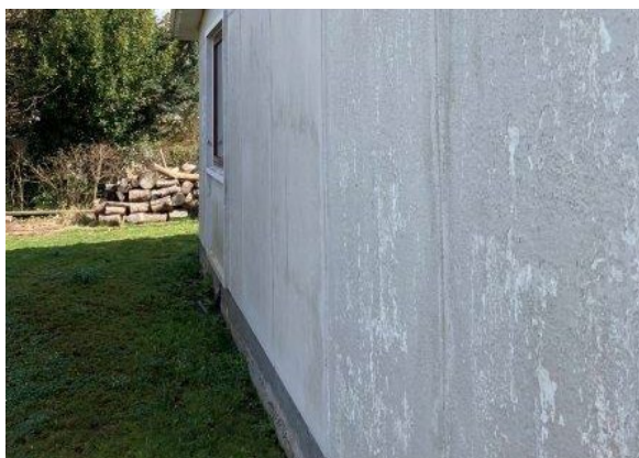
Foto 9.20. Samme gavl hvor der er efterisoleret indvendigt. Gavl fremstår med afskallet maling og puds samt revner i fuger.
