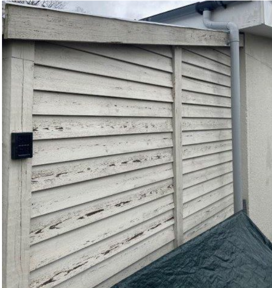
Foto 9.29. Udbygning af skur med manglende vedligehold. Maling er afskallet og træværket er opfugtet.
