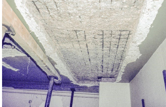
Foto 7.2. Tidligere foto af betontagpladens underside. Armeringsjern er delvist blotlagt. Her er udført armering i begge retninger. Placering og tidspunkt ukendt.
