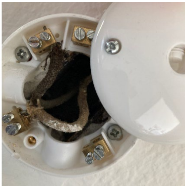
Foto 19.1.1 Eksempel på stofledning i lampeudtag.
