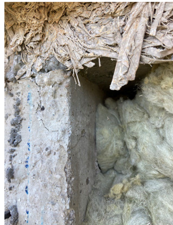
Foto 9.40. Facade. Samling betonsøjle og betonbjælke. Revne og betonafskalling af hjørne. Reduceret kontaktareal i vederlag.
