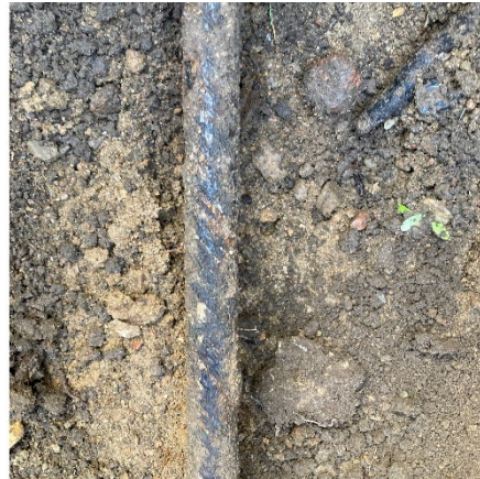
Foto 19.2.2 Eksisterende ældre stikledning i jord.
