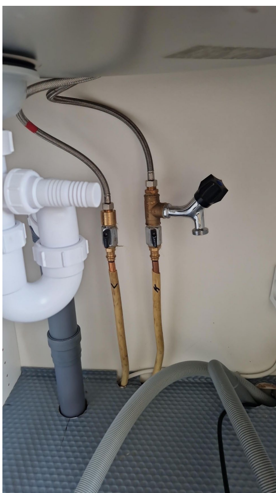
Foto 16.11. Afløb under håndvask.
