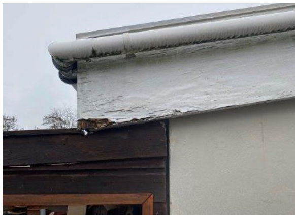
Foto 7.12. Afskallet maling og frønnet træværk med rådskaade
