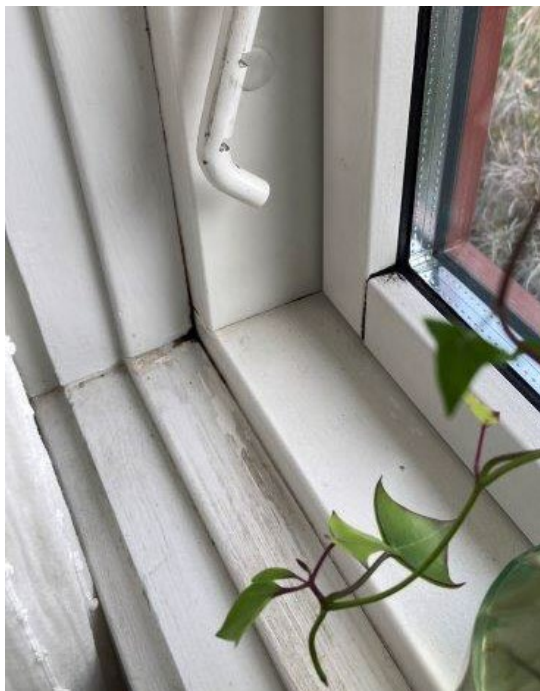
Foto 10.15. Vindue med skimmel i hjørnet af ramme og ved samling mellem karm og tilsætning.
