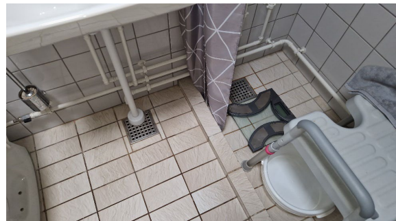
Foto 16.8. Gulv afløb i bruseniche og under håndvask. Afløbet fra brusenichen er ført uden vandlås til gulv afløbet under håndvasken.
