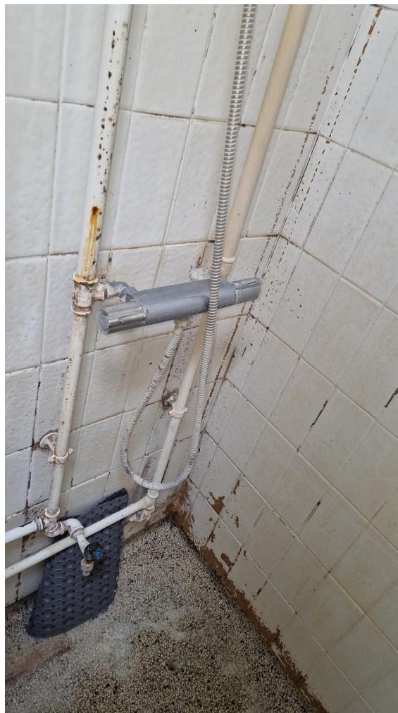
Foto 17.10. Vandinstallation i badeværelse udført i galvaniseret stål.
