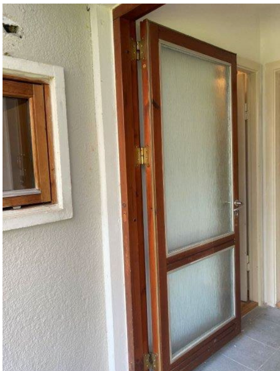
Foto 11.3. Ældre hoveddør i træ.
