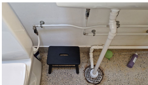
Foto 17.12. Synlig rørinstallation i badeværelse udført i alupex.
