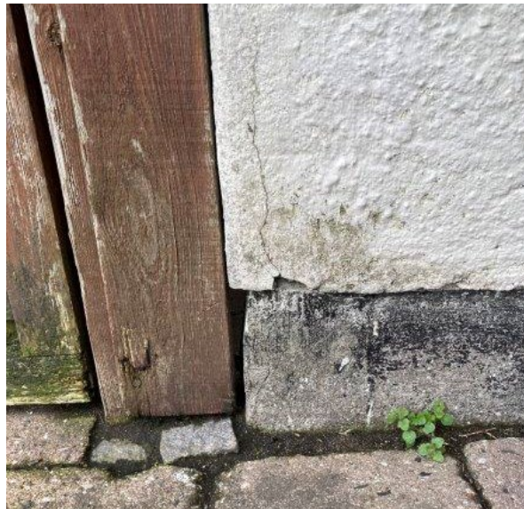
Foto 9.28. Revne og afskallet puds. Opfugtet og træbeklædning på skur med manglende malervedligehold. Sokkel maling er afvasket og der er revne i sokkelpudsen. Træværk (skur) er i kontakt med jord (opfugtes).
