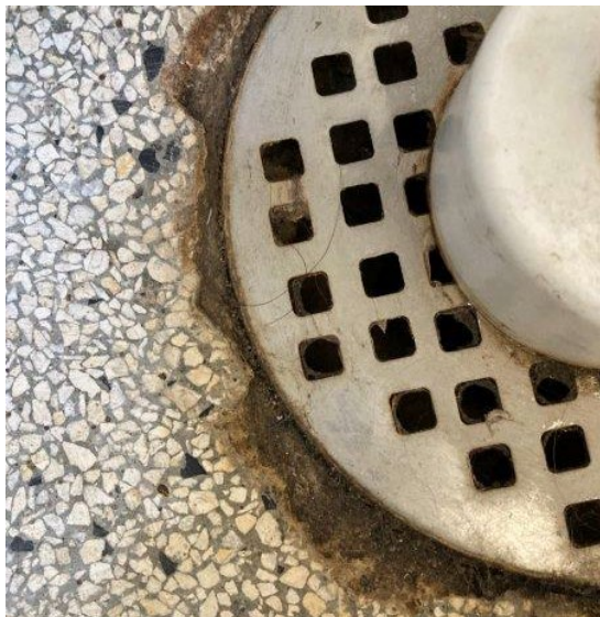
Foto 13.17. Nedbrudt terrazzo omkring afløb
