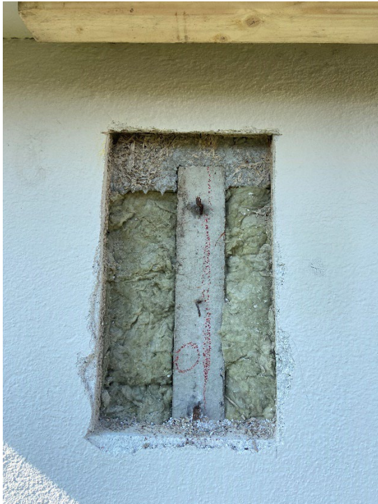
Foto 9.37. Prøvested i facade under tagudhæng. Den øverste del af 100x100 mm betonsøjle og den nederste del af betonbjælken er bortlagt.
