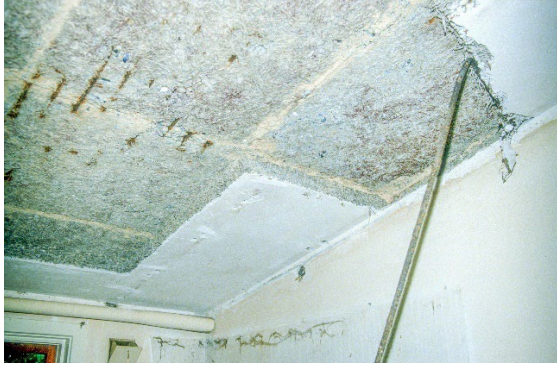
Foto 7.1. Tidligere foto af betontagpladens underside. Armeringsjern er delvist blotlagt. Placering og tidspunkt ukendt.
