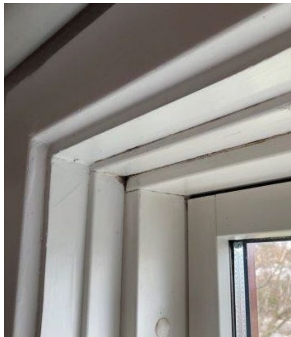
Foto 10.16. Vindue med skimmel mellem karm og tilsætningsliste.
