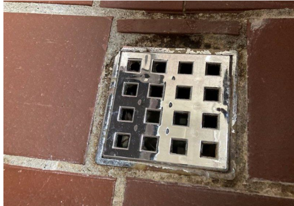
Foto 13.16. Udskiftede fliser og afløb, ca. 80'erne. Nedbrudte mørtelfuger.
