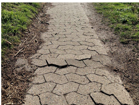
Foto 20.3. Ujævne flise, risiko for personskade.
