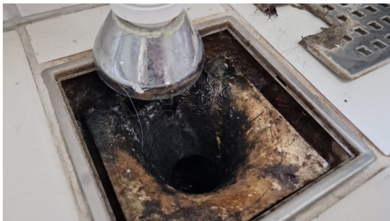
Foto 16.7. Gulv afløb under håndvask – fælles for bruseniche og håndvask
