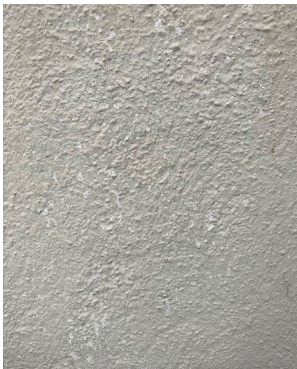
Foto 9.10. Puds med afskallet maling
