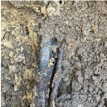
Foto 19.2.1. Eksisterende ældre stikledning i jord
