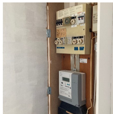
Foto 19.1.8 Eksempel på ældre boligtavle udvendigt.
