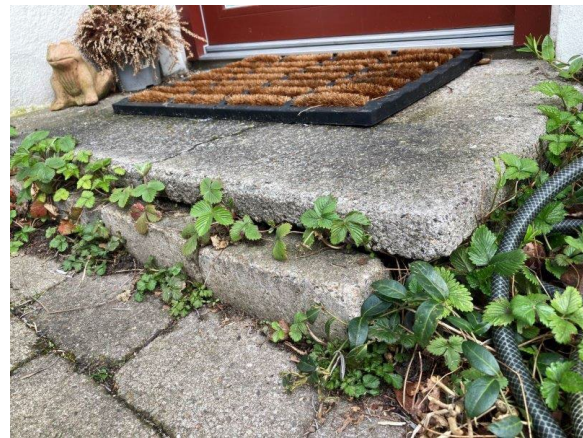
Foto 20.10. Dørtrin med omfattende revnedannelse.
