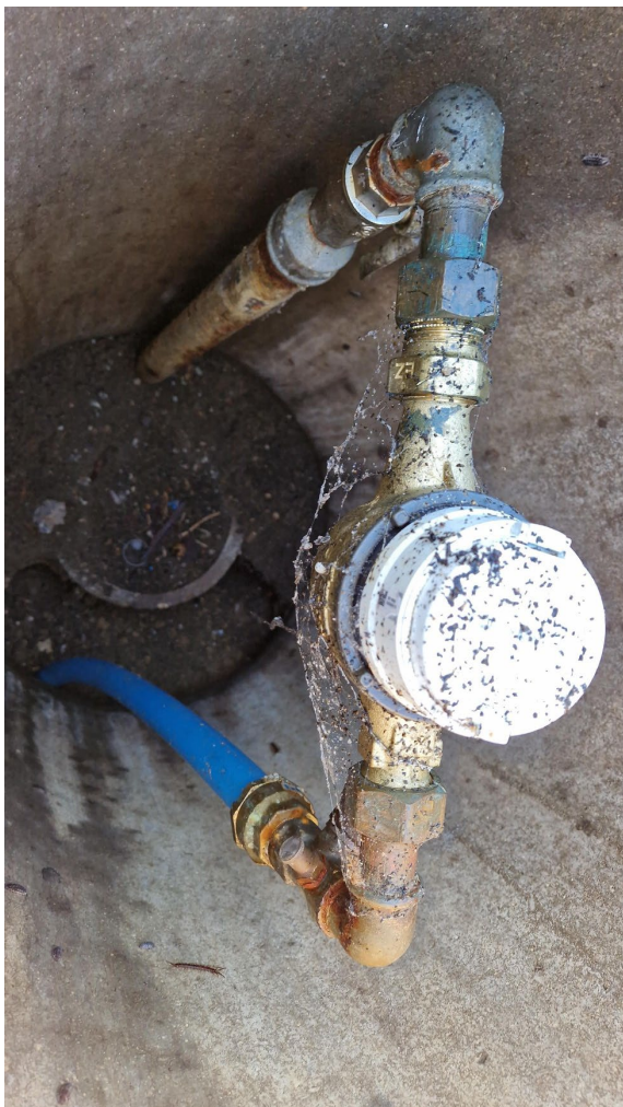
Foto 17.9. Målerbrønd. Forsyningsledningen er udskiftet til PEM rør, imens vandledningen fra vandmåleren og frem til boligen er galvaniseret stålrør.
