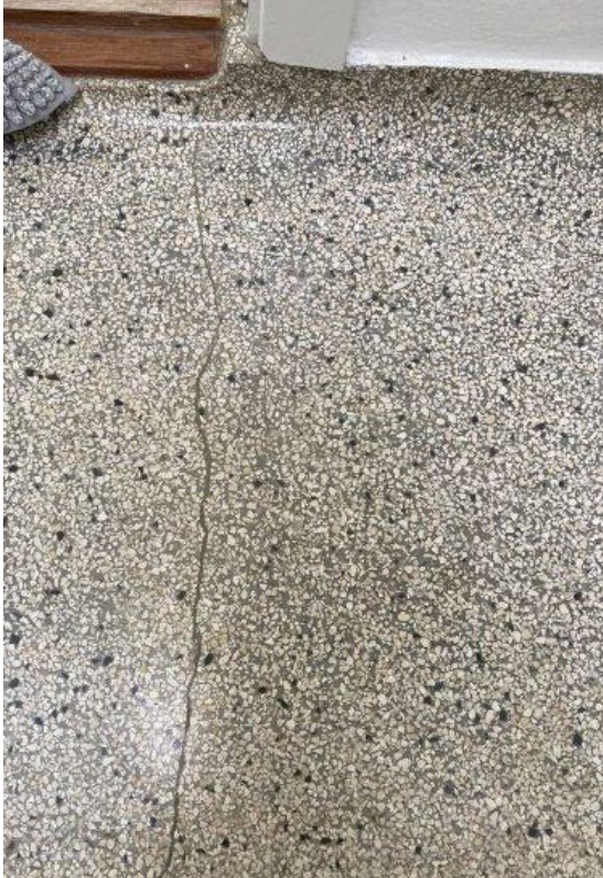
Foto 13.11. Terrazzogulv med lange revnedannelser fra dør til toilet.
