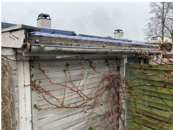
Foto 7.11. Stern på skur med afskallet maling, frønnet træværk og defekter lister på udhæng
