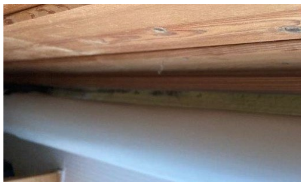
Foto 9.24. Skimmeldannelse mellem loft og væg i køkken over vindue.
