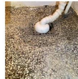
Terrazzo belægning med kraftig revnedannelse
