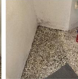
Terrazzo med revnedannelse + væv med væv
