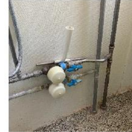
Brugsvandsinstallationer i vådzone
