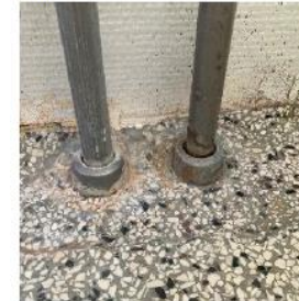
Brugsvand, Karfa bøsning for tætning i gulv
