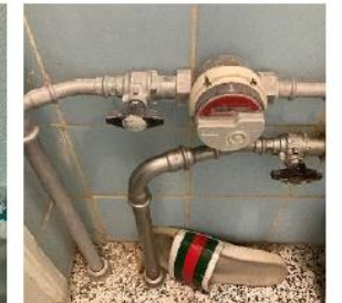
Blå vægfliser, miljøprøver angiver asbest i fliser/klæb.
